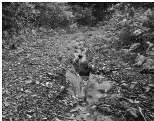
図 1 洗掘された林道の例
