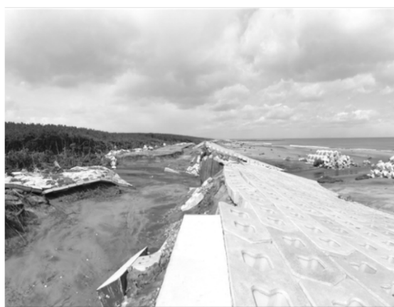
津波が乗り越え被災した緩傾斜堤
