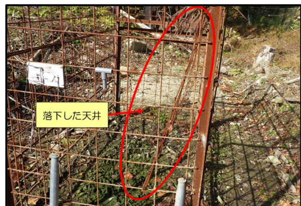
図6. 破壊された天井
