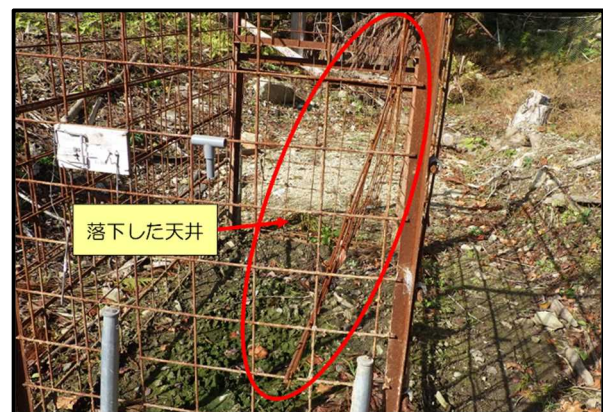
図6. 破壊された天井
