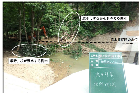
写真－６ 危険木等処理前の状況
