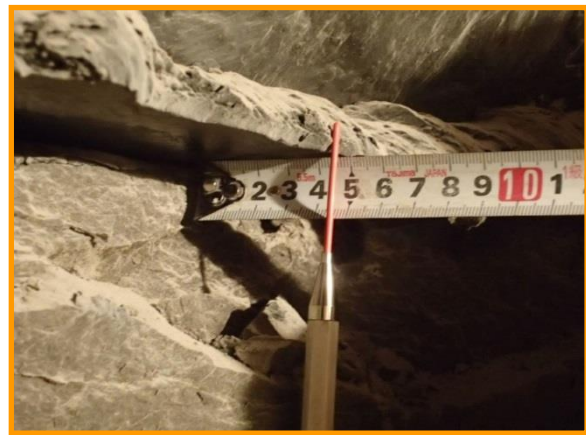
写真2. 破断面接写写真
