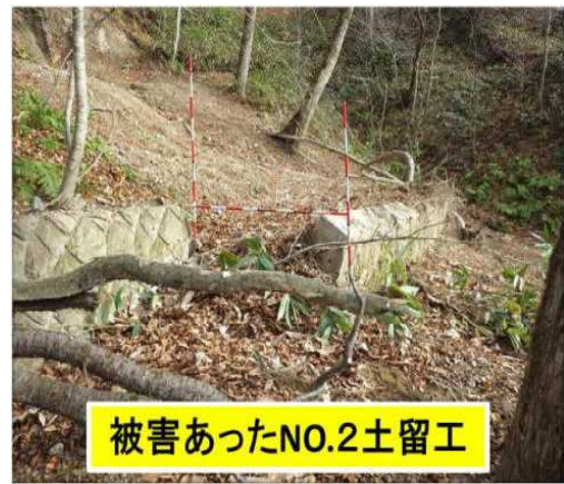
図-3 NO.2土留工の転倒
