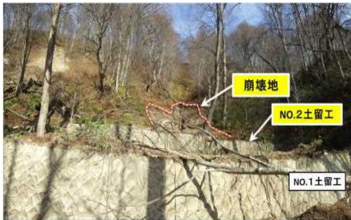
図-2 治山施工地被害の全景
