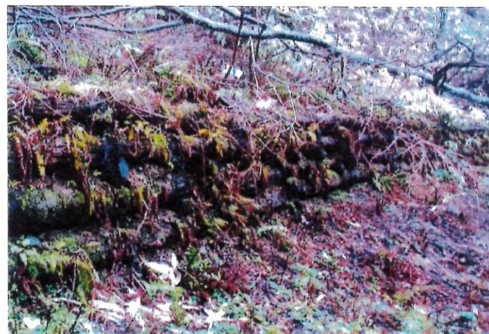
③ 秋田署 腐朽度合い40-50%で苔類が着生している。
