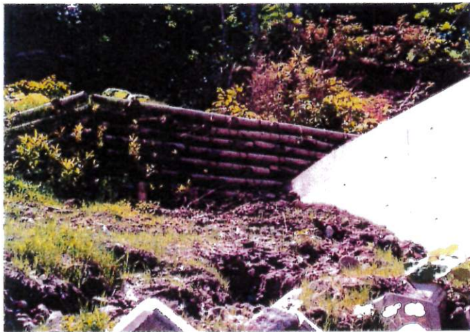
① 十和田署 地際部分の腐朽が認められる。
