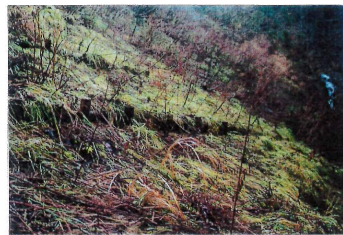
④ 秋田署 腐朽もなく特に異常は認められない。 斜面は草本に被覆され安定した状態である。
