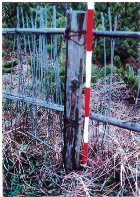
① 能代署 地際部分の腐朽が認められる。
