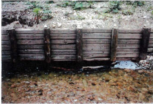
⑤ 増田署 地際部10-20%の腐朽が認められる。
