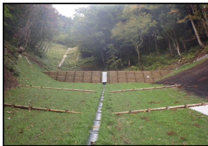
工事名：針水沢第二治山工事（令和3年度完成） 施行地：秋田県由利本荘市鳥海町上笹子字大台国有林 （由利森林管理署管内）
