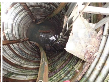
既設集水井の破断状況
