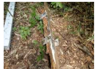
仮設支柱の倒壊(B-5)
