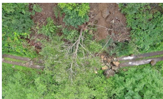
法面から林道上への土石崩落の状況（ドローン撮影）
