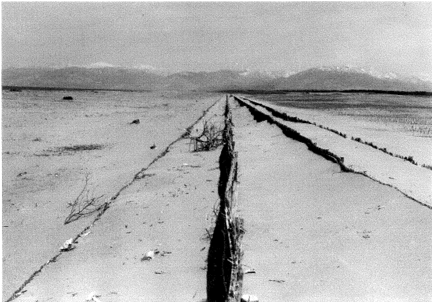
造成された砂丘の頂部は、風によって浸食されないよう柵で固定する。(大開浜 S.33)
