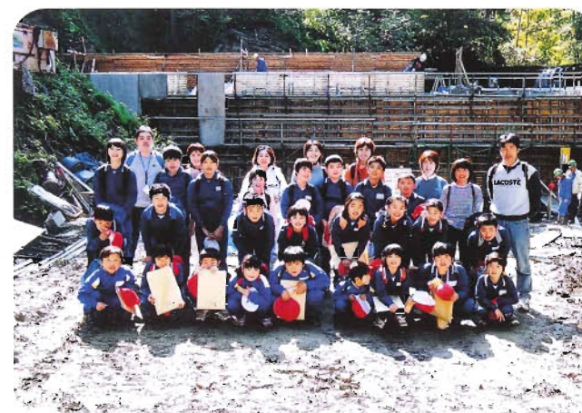
地元尾花沢市立上柳小学校（27名の生徒）の工事見学会。はじめてのダム工事現場に少し緊張。
