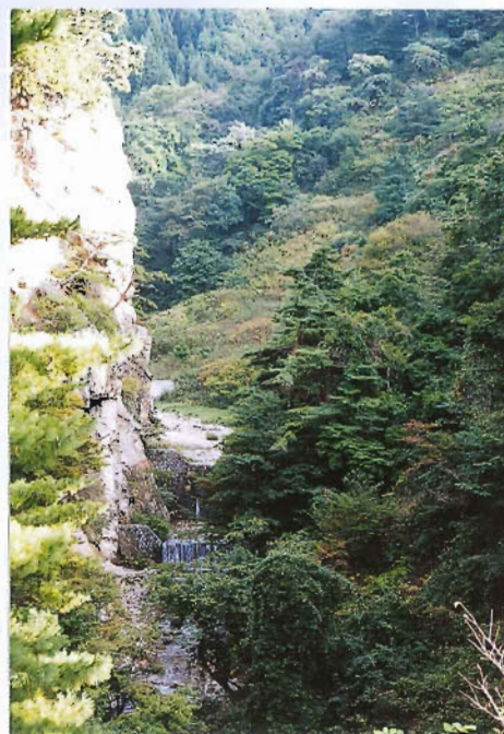
溪床の荒廃を防いできた練積ダム。右斜面が地すべりを起こしている。
