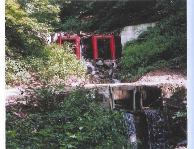
土石、流木をくい止めたスリットダム
