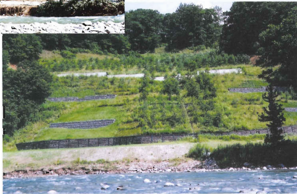
アンカー工・集水井工・土留工などを施工。(平成13~15年度施工)
