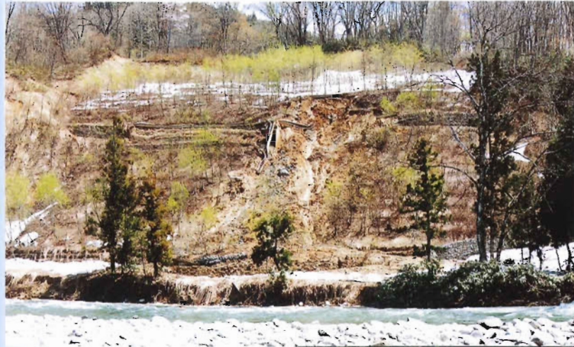
平成12年の融雪により地すべり性崩壊直後のタキブチ山腹。
