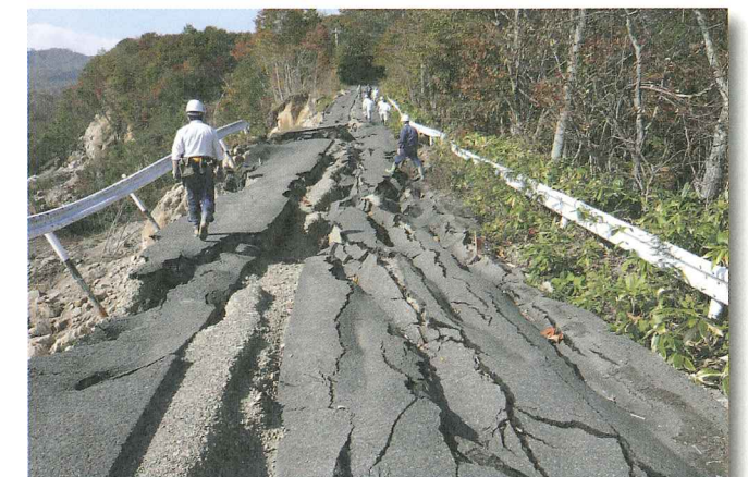
5 御沢支溪 市道の被災状況
