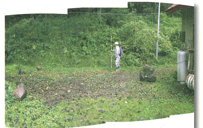
3 洞万区域 崩落した落石が民家裏へ 民家裏斜面防災点検での調査
