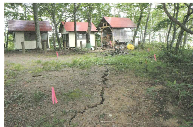
9 御沢崩壊地直上部の家屋 亀裂が確認される
