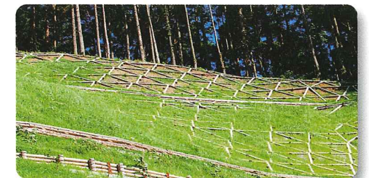
間伐材丸太でつくった法枠工八洲山(秋田県由利本荘市)〈由利森林管理署〉
