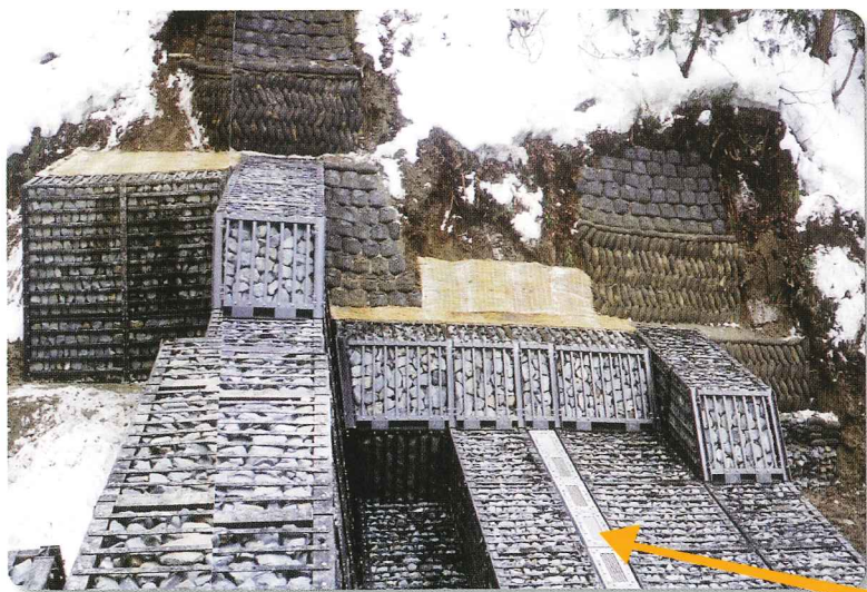
鋼製（玉石・木炭詰）透水型治山ダム 母沢（青森県青森市） 〈青森森林管理署〉
