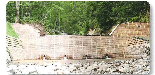
木製の型枠をそのまま残したコンクリート治山ダム倉形沢(岩手県八幡平市)〈岩手北部森林管理署〉
