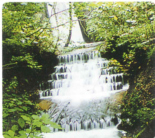
昭和28年にヒバ材でつくった木製治山ダム
