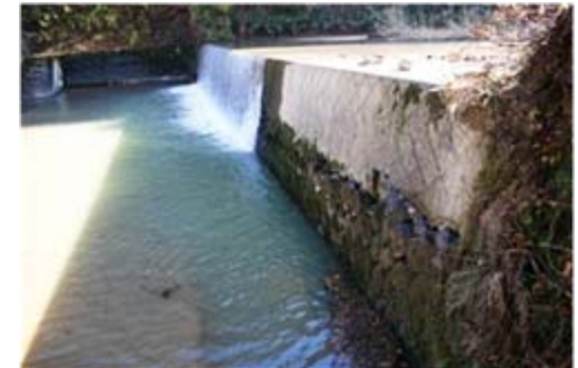
産女川治山ダム 施設被害状況
