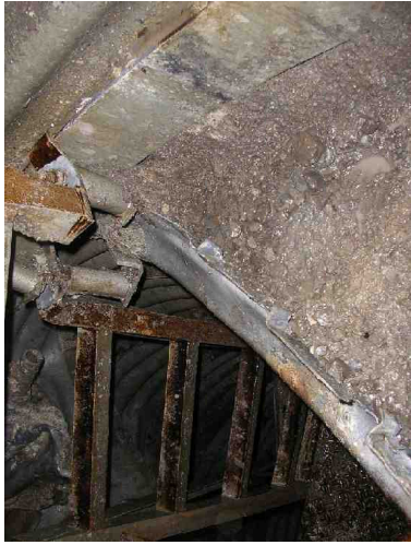
尿前沢 地すべり 集水井の破壊
