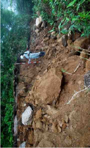
冠頭部滑落崖 上方斜面の拡大亀裂
