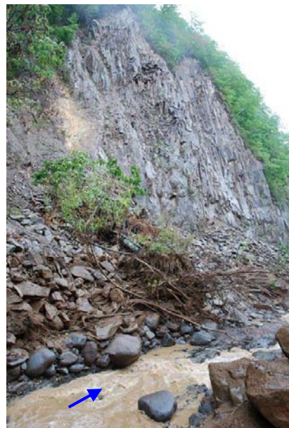
⑧山腹崩壊状況・柱状節理の発達した溶岩の崩壊
