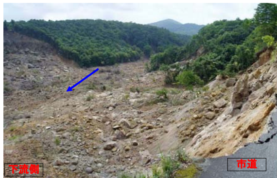
⑤冷沢崩壊地群(不安定土砂堆積状況)
