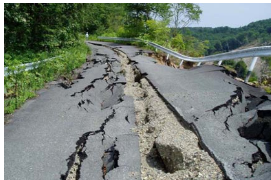
⑤市道の被災状況
