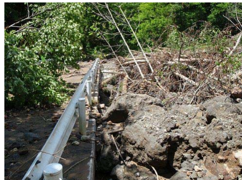
崩壊末端に位置する橋梁
