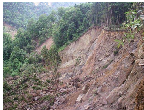
第3河道閉塞の原因となった崩壊滑落崖
