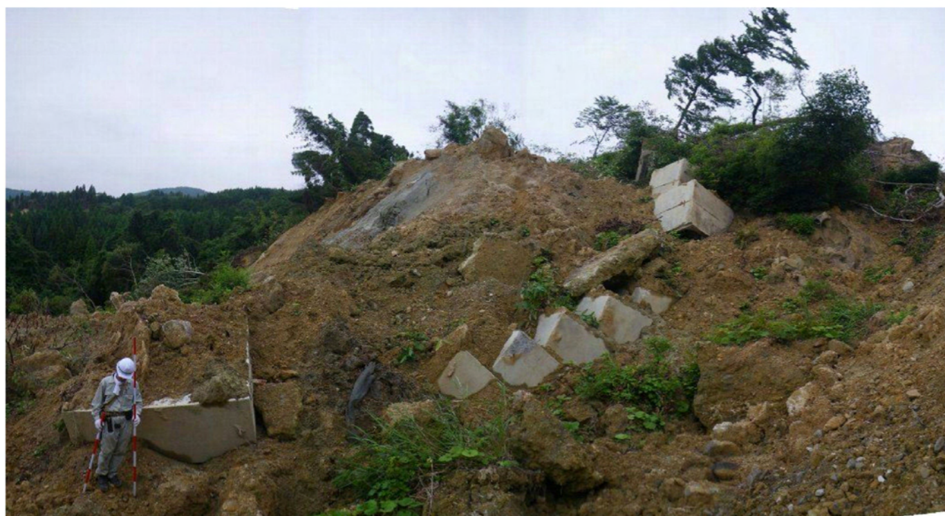
⑦ 擾乱帯の地表に押し上げられた構造物
