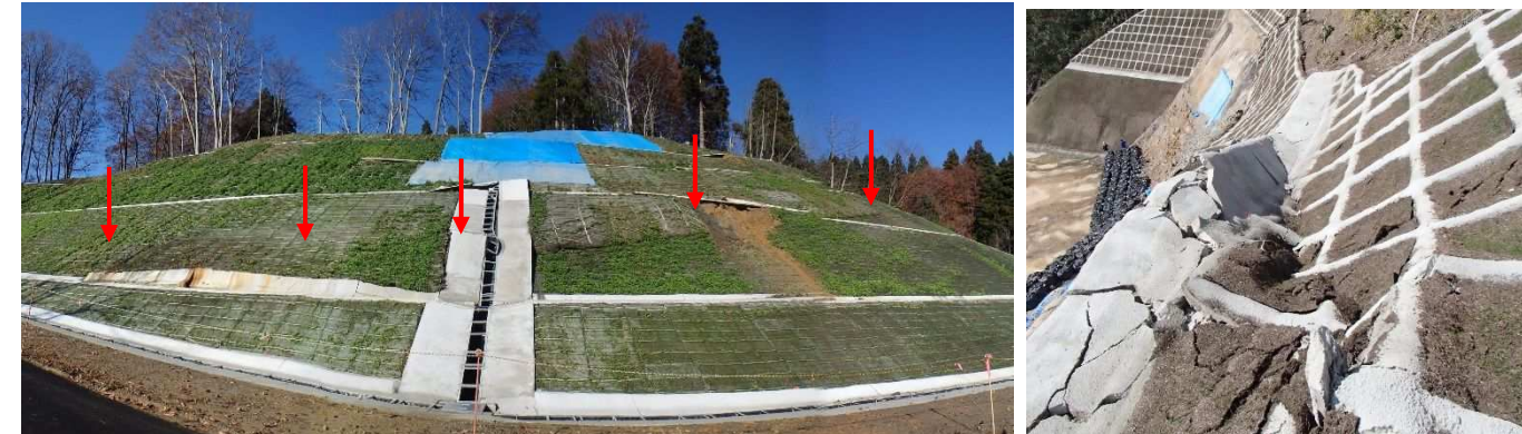
のり面内に筋状の段差、亀裂、表層土の流出等が確認され、構造物はクラック発生→破損と変状が大きくなる。
