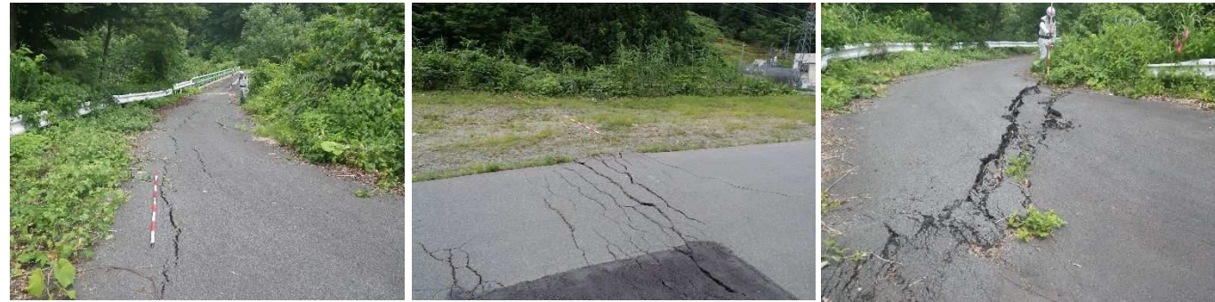
アスファルト路面に亀裂が確認され、活動が大きいほど亀裂規模や数が増え、開口や段差も生じる
