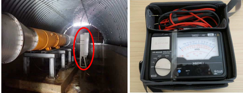
写真：換気ファン制御盤と絶縁抵抗計
