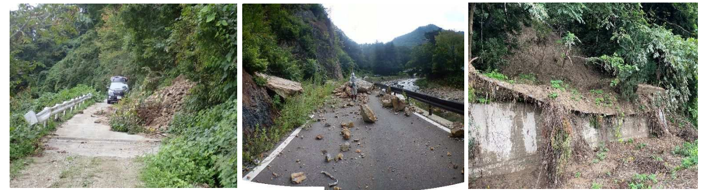
土砂、転石の流出、植生、立木の抜け落ち等が発生し、規模が大きい場合、防護柵等の施設が破損する
