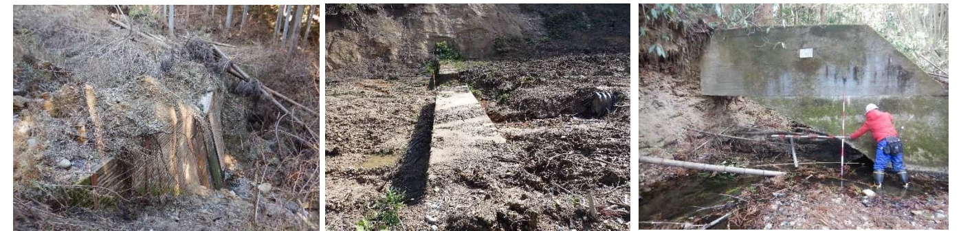
既存の施設を乗り越えた土砂や流木の流出、既存施設への異常堆砂や異常侵食が確認される
