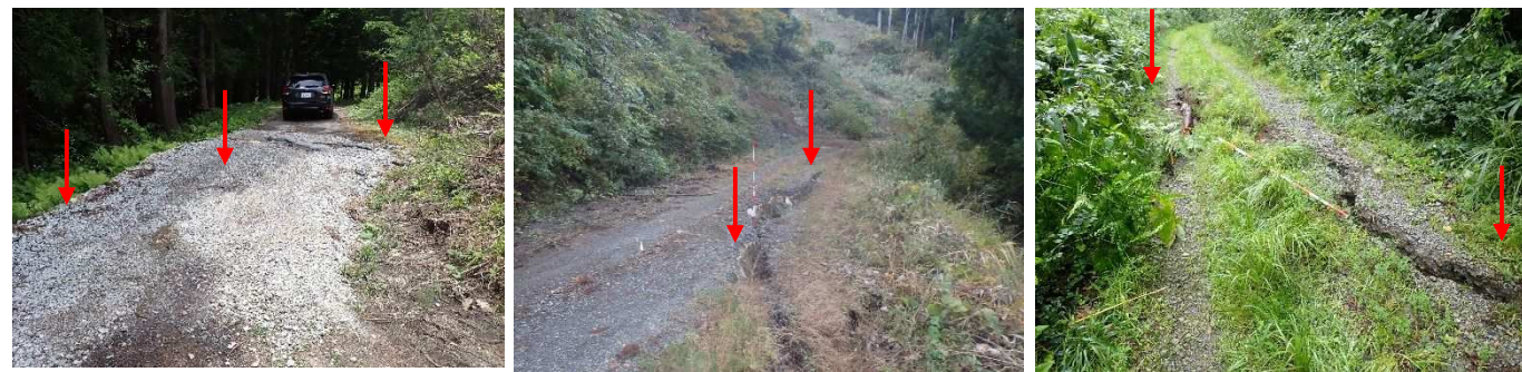
未舗装路では路面の変形（沈下や隆起）、路肩等に亀裂が発生する
