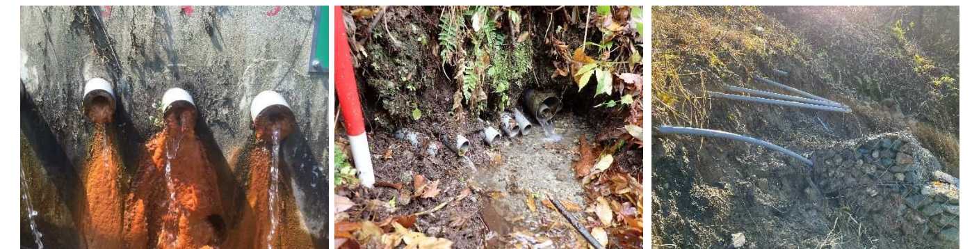
スケール付着等による孔口の閉塞、土砂等による孔口の埋没、崩壊等による孔口の破損が確認される
