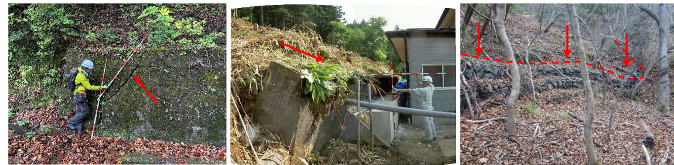
コンクリート土留工ではクラック→開口亀裂→前傾と変状が大きくなる。かご枠等では変形、不等沈下等が発生する
