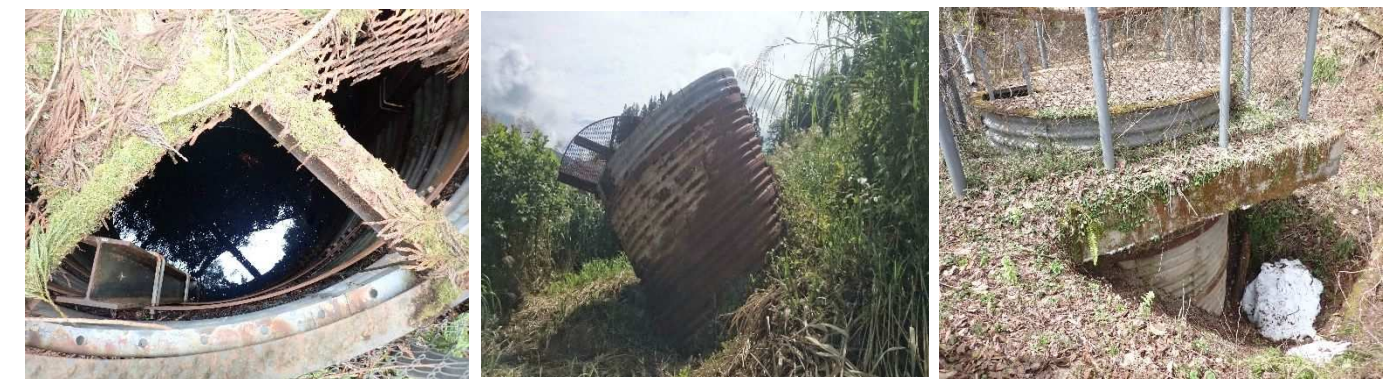
集水井の異常湛水や土砂堆積、井筒の傾倒や破断、地表面の吸出し等が確認される
