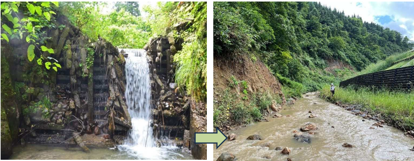
写真 5.2 FU-K-04 左：堤体砕材の破損（H26 年度点検時）、右：代替施設（谷止工+護岸工）による整備状況
