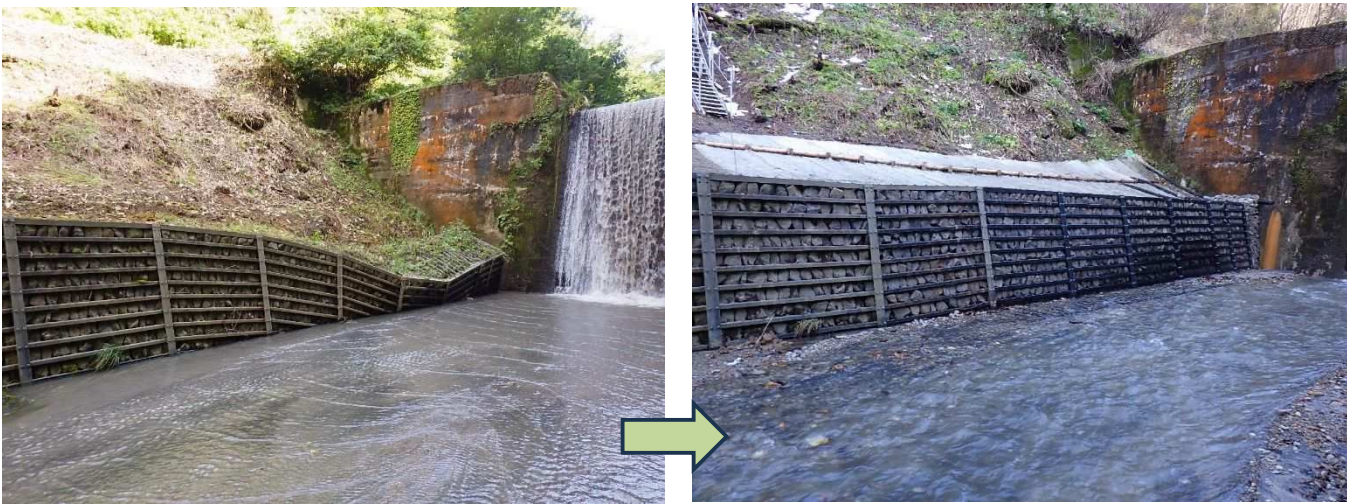
写真 5.1 FU-K-53 左：護岸工の傾倒（R4 年度点検時）、右：護岸工の補修工事実施状況（R7 年度）
