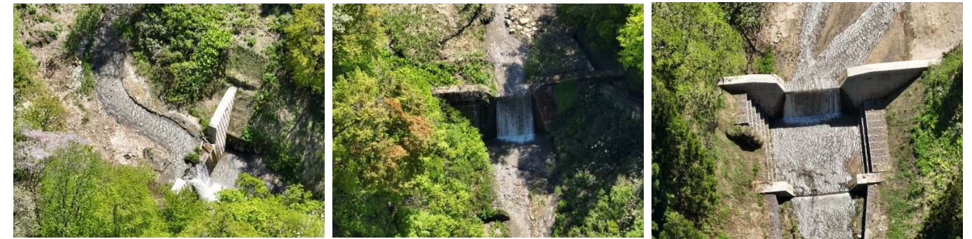
写真 5.34 古水川の治山施設状況（左：R1 NO.1 谷止工、中：S50 谷止工、右：R2 NO.3 谷止工）
