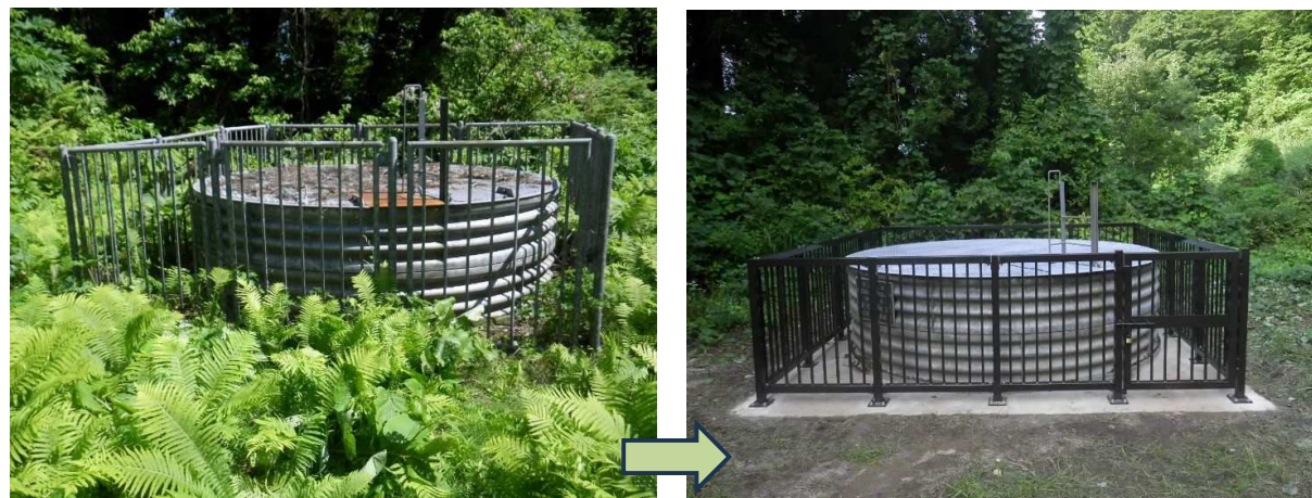
写真 5.13 SA-S01-W01 左（防護柵の破損、天蓋の腐食）右（同交換）
