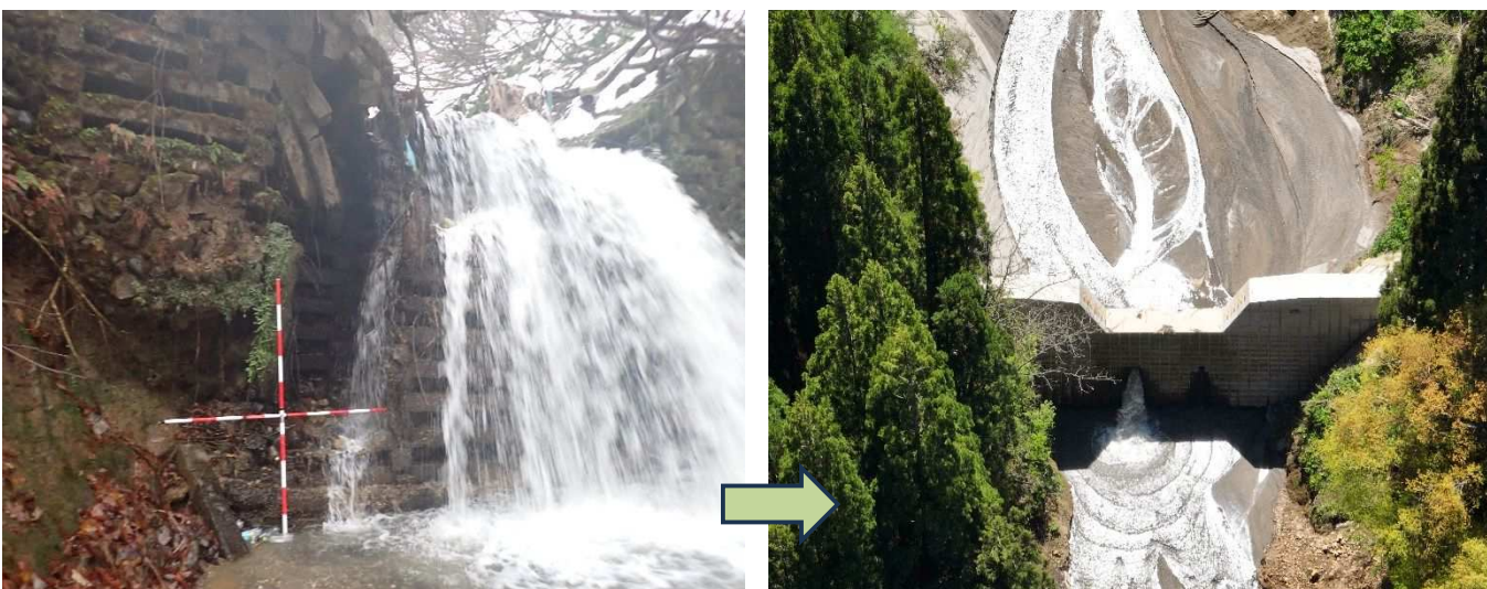
写真 5.3 FU-K-07 左：堤体砕材の破損（H26 年度点検時）、右：代替施設（R4 谷止工）による整備状況
