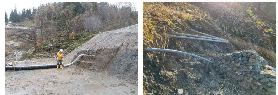
写真 5.11 令和8年度に補修工事が計画されているMI-S07-1ブロックの地下水排除工
