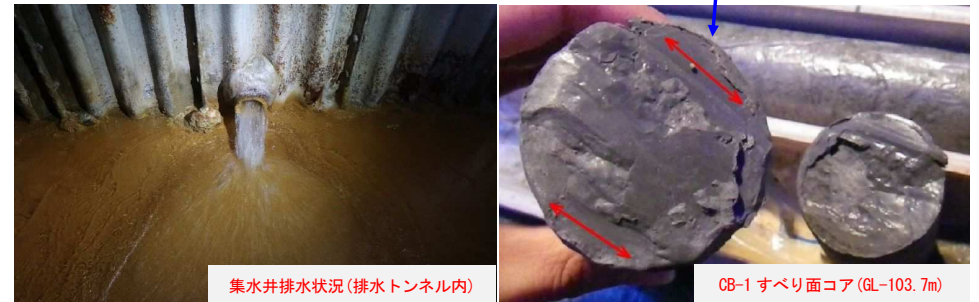
集水井掘削時に確認されたすべり面
