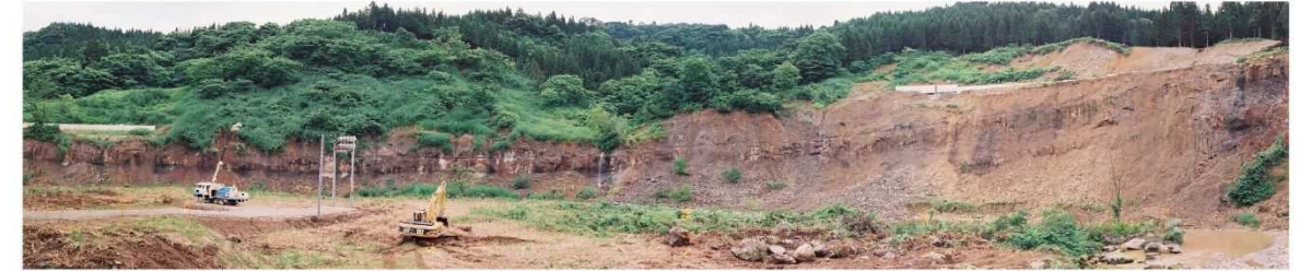
2 地すべり末端部状況
