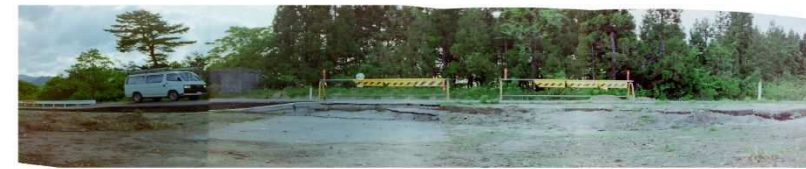
18 国道 458 号沿いに発生した陥没帯下流壁 (写真奥が斜面下方)
