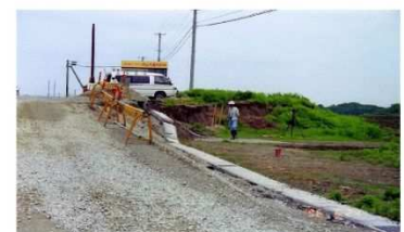
20 陥没帯の下流壁 (写真左手が斜面下方)
