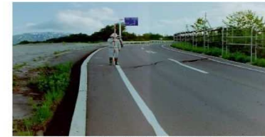
13 ブロック右側壁中段部の国道 458 号に発生した亀裂
