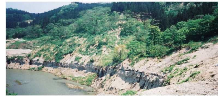
1 地すべり末端状況 (帯急傾斜がすべり面)
