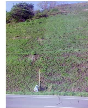
11 ブロック右側壁中段部の国道 458 号の法面に発生した亀裂
