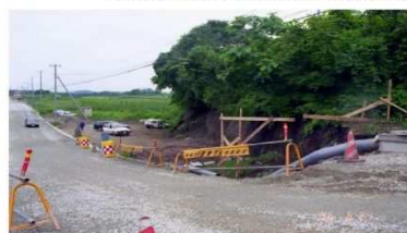
21 陥没帯の上流壁 (写真左手が斜面下方)
