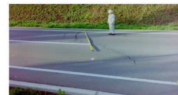
12 ブロック右側壁中段部の国道 458 号の法面に発生した亀裂
