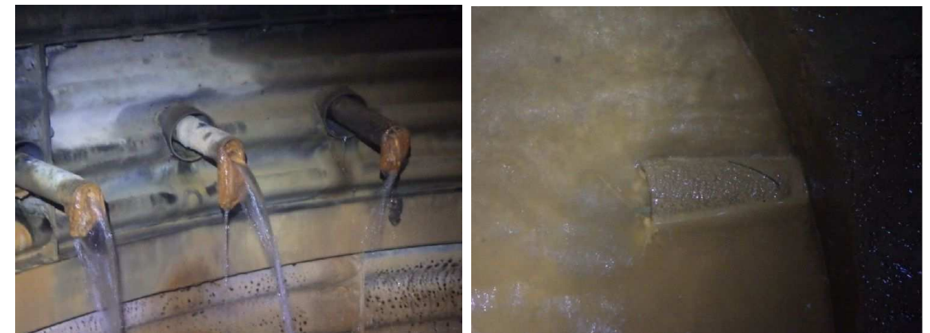
写真 2.10 SA-S01-W01 左 (上段集水ポーリングの閉塞状況、閉塞率 50%以上が 11/27 本) 右 (静水槽の堆砂 90%、排水ポーリング呑み口 50%閉塞)
