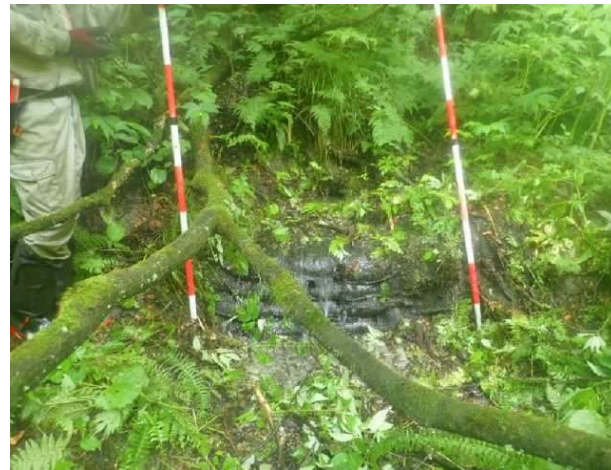
写真 2.21 DO-K-B14 ボーリング暗渠工の口元は埋積
