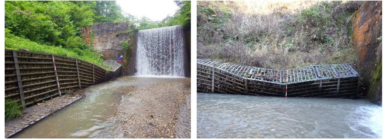
写真 2.1 FU-K-53 (R4.6.11 点検) 護岸工の倒壊
