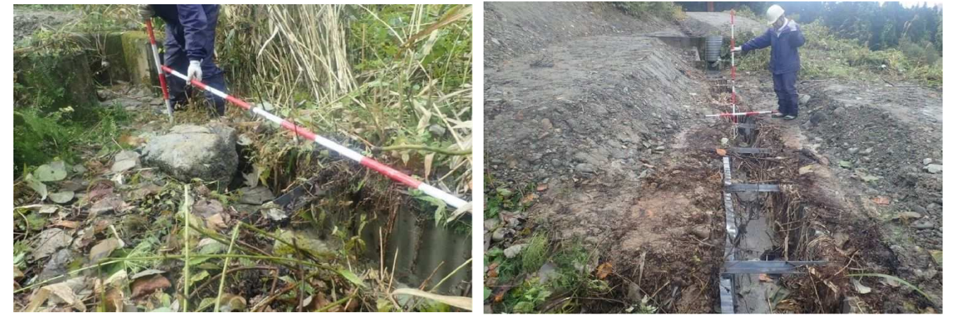
写真 2.32 MI-S07 ブロック水路工 (TA-K-04) の被災状況 (現在は切土工により消失)
