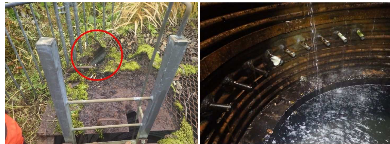
写真 2.9 MI-S03-W01 左 (天蓋の腐植と一部欠損) 右 (集水ポーリングの状況)
