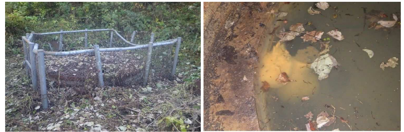
写真 2.14 SA-S01-W08 左（防護柵の損傷） 右（静水槽土砂の堆積と排水ボーリング呑み口の閉塞）
