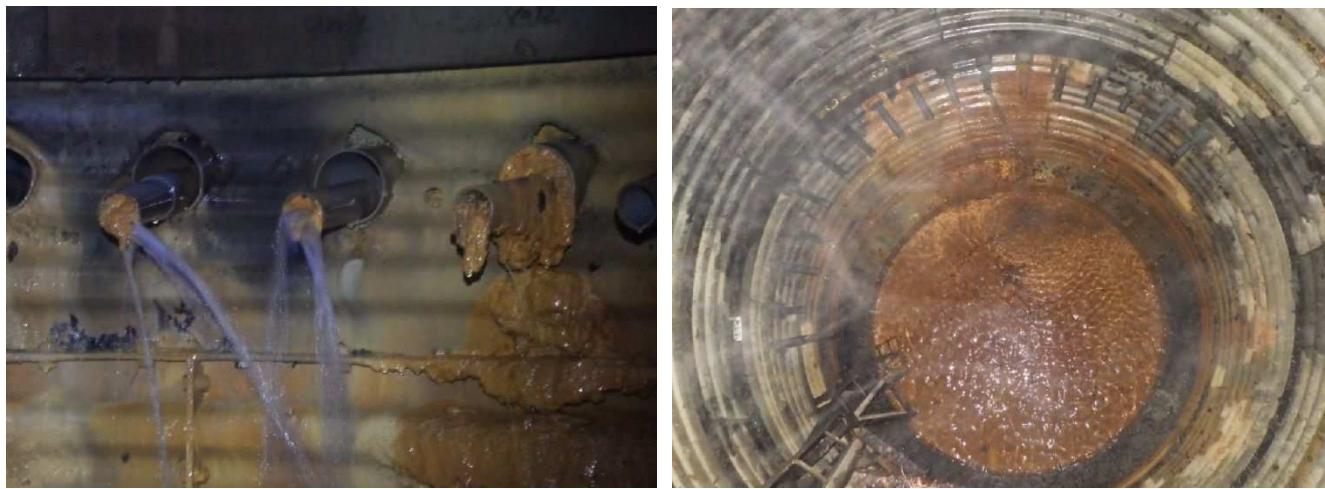
写真 2.11 SA-S01-W02 左（集水ボーリングの閉塞状況、閉塞率 50%以上が 4 本/27 本中） 右（静水槽の堆砂 90%、排水ボーリング呑み口 30%閉塞）
