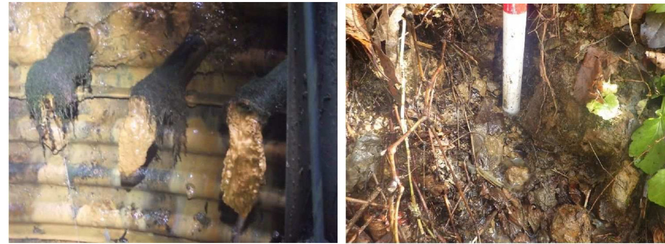
写真 2.8 MI-S04-W01 左 (集水井ポーリング閉塞状況) 右 (排水ポーリング出口の埋設)
