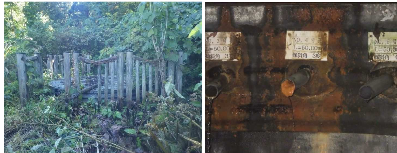
写真 2.12 SA-S01-W03 左（防護柵の破損） 右（集水ボーリングの閉塞状況、閉塞率 50%以上が 3 本/11 本中）
