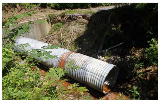
令和6年度被災 孫沢林道被災時
