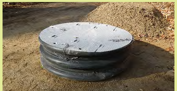
大型排水管を利用した残渣処理設備
