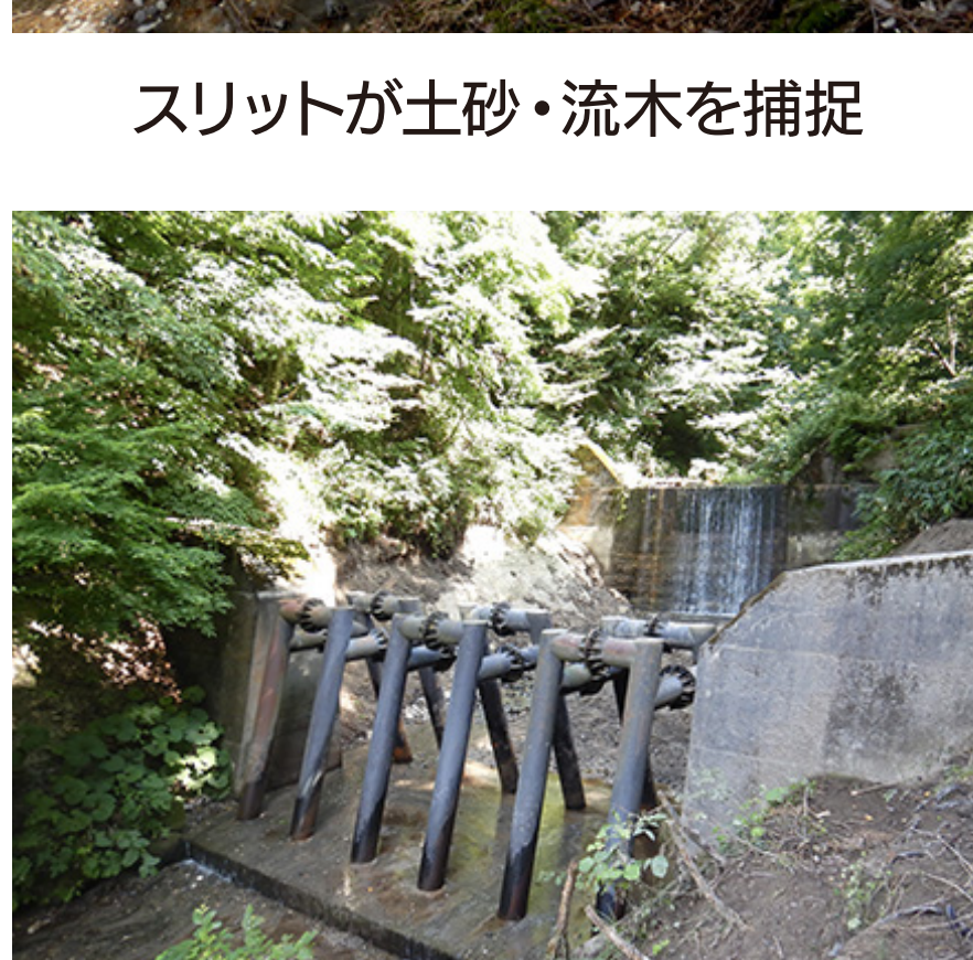
スリットが土砂・流木を捕捉
