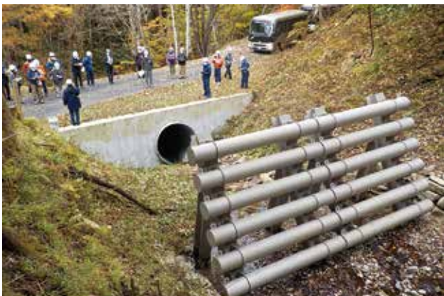
土石流フェンスの見学
