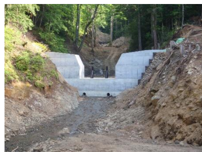
【治鋼製スリット谷止工（むつ市）】
