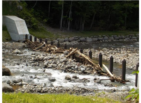
流木を捕捉するスリットダム (馬淵川上流森林計画区)
