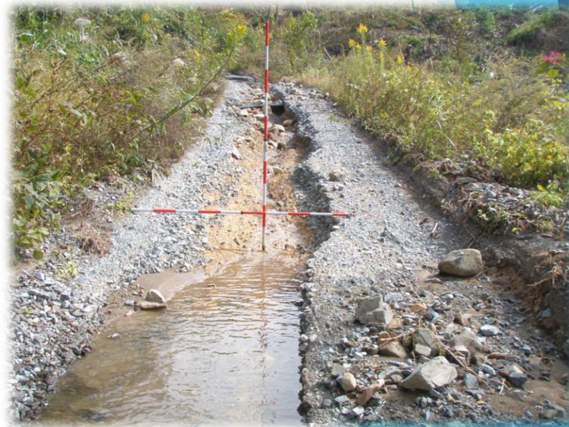
台風災害による林道の洗掘状況
