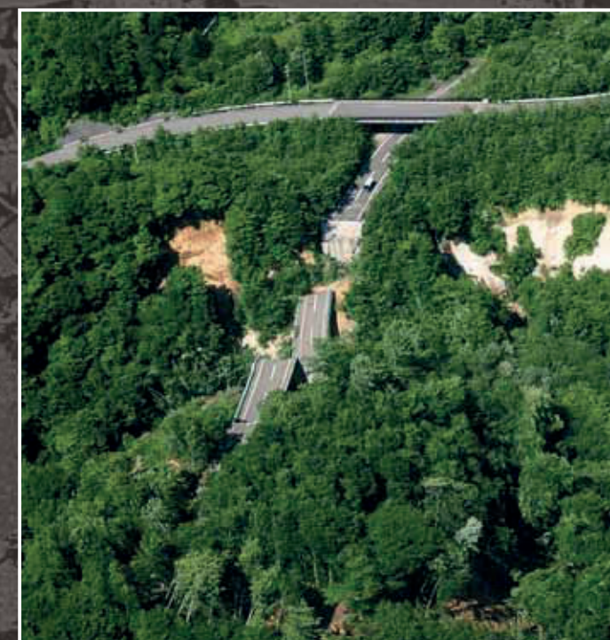
祭時(まつるべ)大橋 地すべりにより橋台・橋脚ごと移動し、落下したと考えられている【国道342号・岩手県一関市巖美町】
