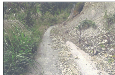
法面の崩壊箇所状況
