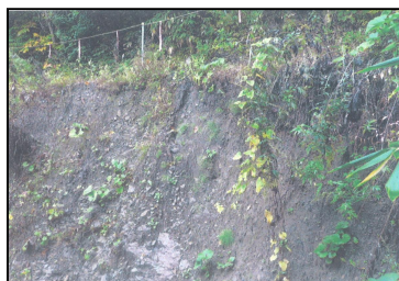
路肩の異常箇所状況
