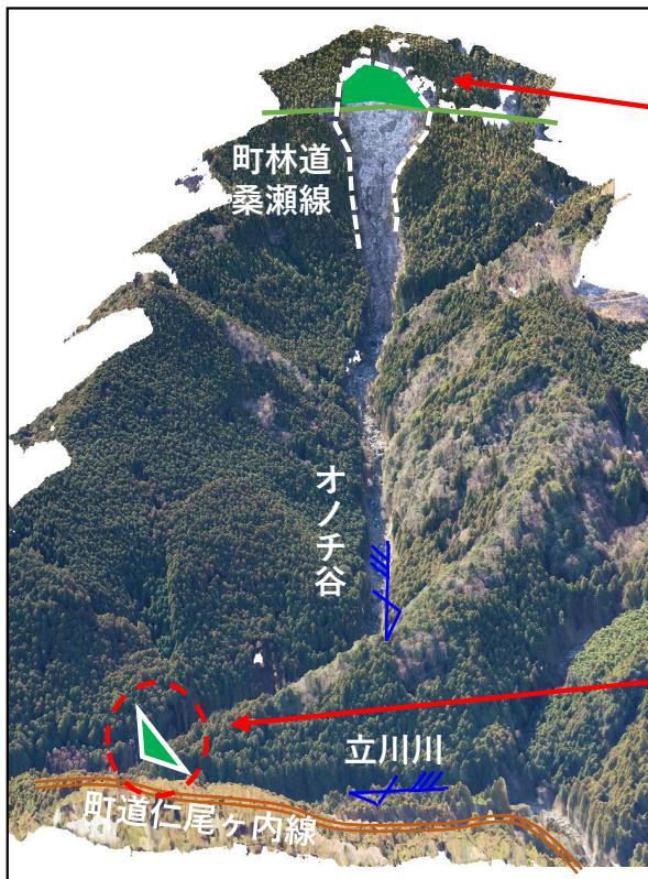
仁尾ヶ内区域 山腹崩壊地全景
