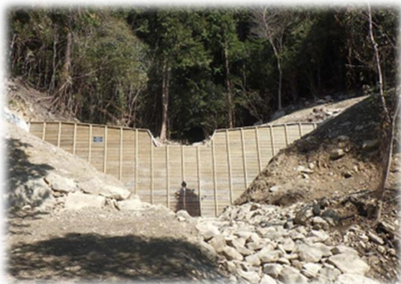
荒廃した溪流に設置された堰堤 (東かがわ市 兼広国有林)
