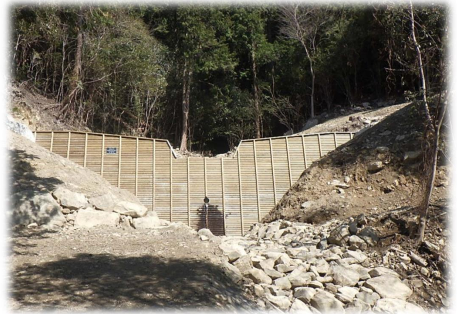
溪流に設置した堰堤（コンクリート谷止工：木製残存型枠）
