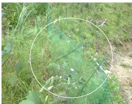
タイプE 支柱の破損
