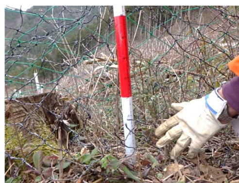
写真6 タイプD本体ネットの破損
