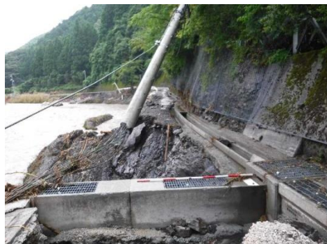
高知県安芸市の県道の被害状況
