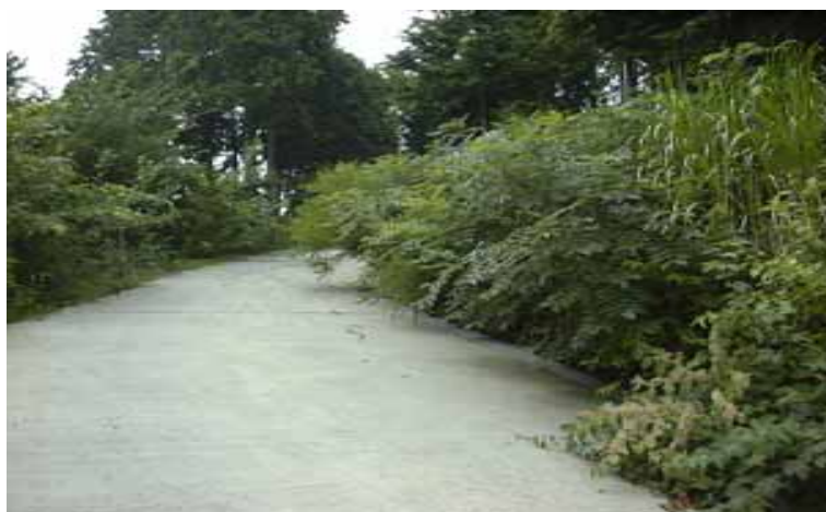
丸太伏工を布設していない林道の状況（視界が不良）
