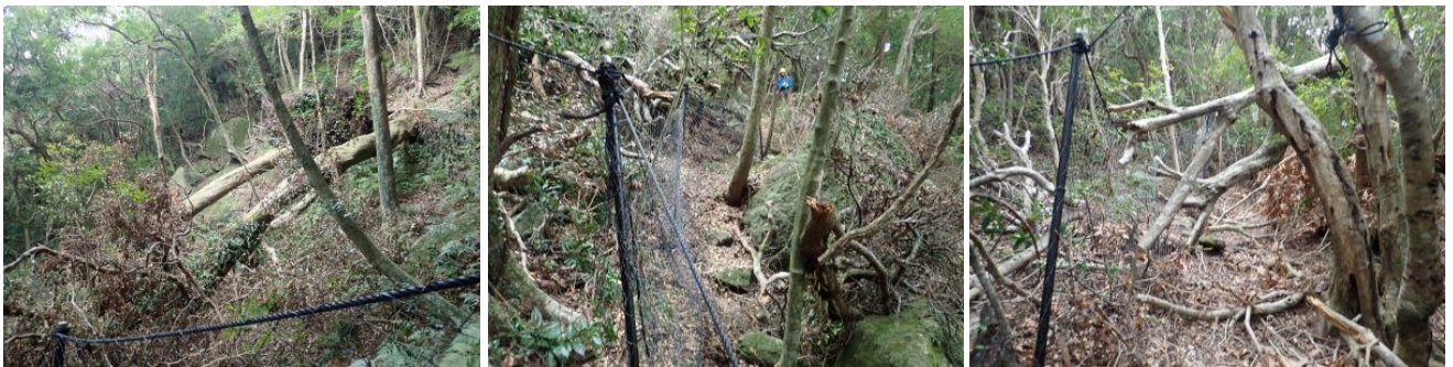
被害状況（400m 地点）（左）、ネットの張り直し（中）、倒木処理後（200m 地点）（右）
