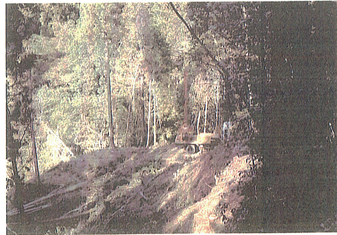
タワーヤード設置状況
