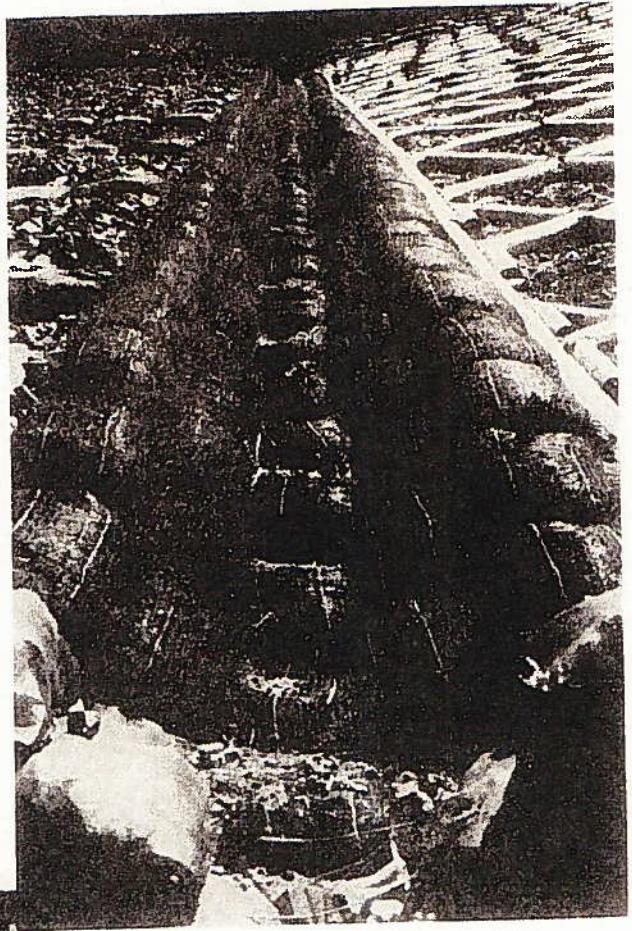
植生土のう水路
