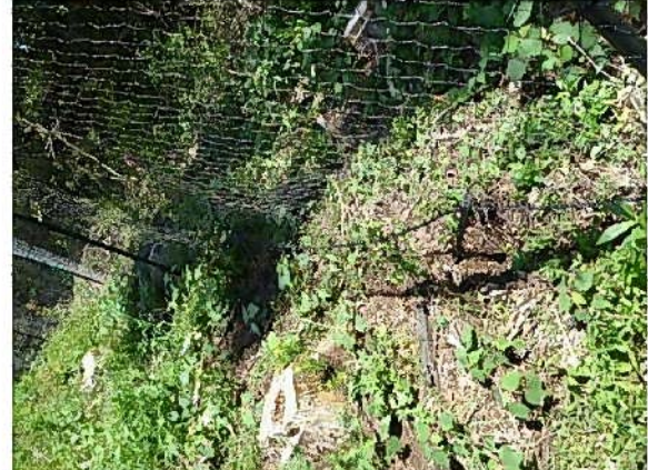
写真－11 アンカーピン抜け状況
