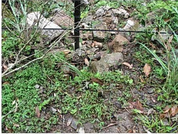
写真-18 アンカーピン設置不可能箇所
