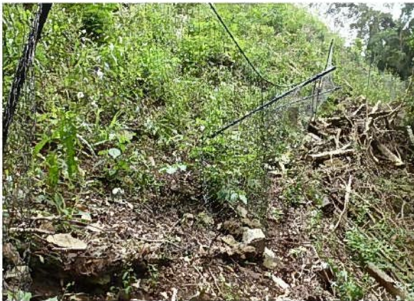
写真－10 垂直張り方式土砂及び石流入堆積状況
