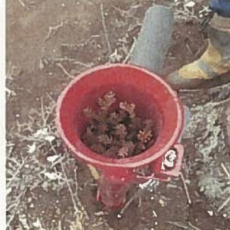
写真-8 PT内での枝詰まり
