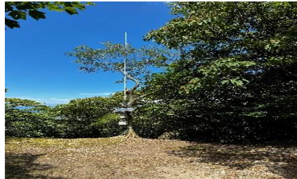
LPWA無線通報システム(親機)
