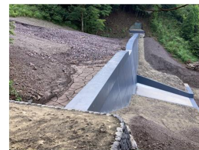
流出した不安定土砂の捕捉状況
