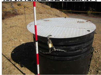
大型排水管用いた残渣減容化施設 写真：近畿中国森林管理局より提供
